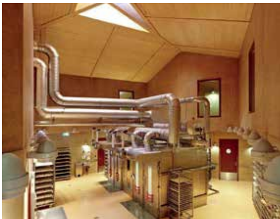
Die Backofen-Abwärme wird oben zur Wiederverwendung rückgewonnen. (Bild: Ralph Feiner)
